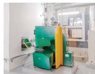
木質チップを熱利用するためのボイラー
