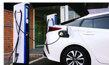
かんぼの宿に設置されたEV充電器
