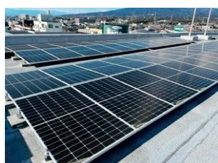
太陽光パネル
