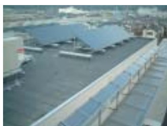
小田原東郵便局 屋上の太陽光発電用パネル
