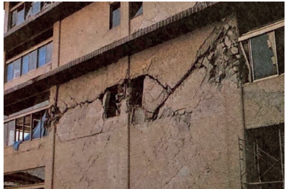
〔外壁が大きく壊れた神戸中央郵便局〕
